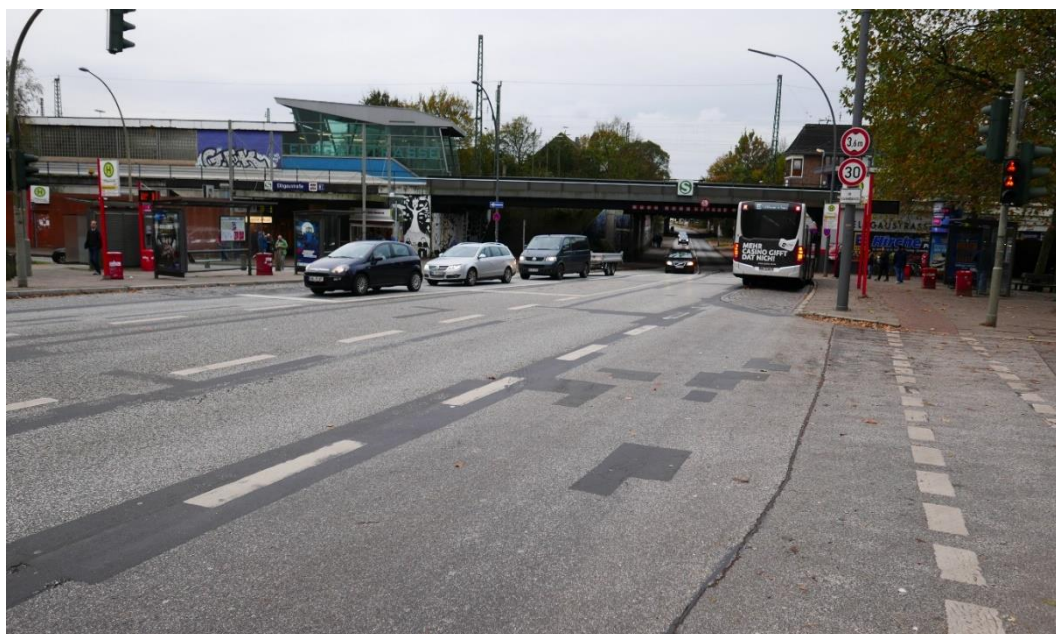
Abbildung 3: Schadensbild an der S-Bahn- und Bushaltestelle Elbgaustraße
